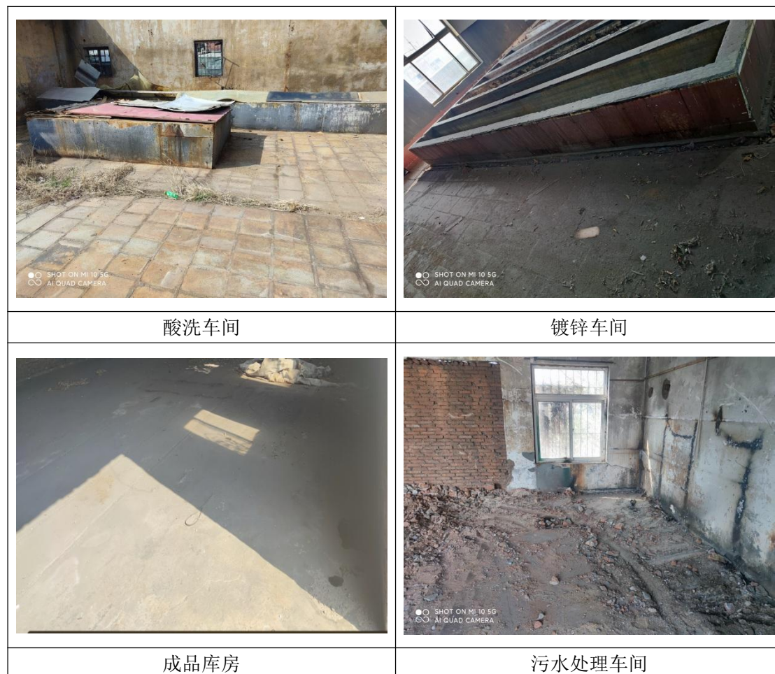
图 3.3-5 车间地面防渗情况
