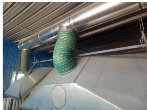
喷漆房内废气处理收集管道
