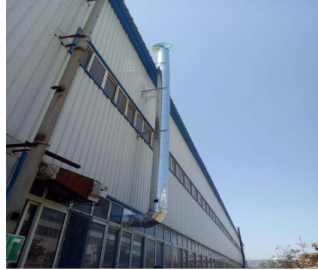
15m 高排气筒
