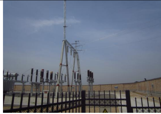
110kV 配电区域
